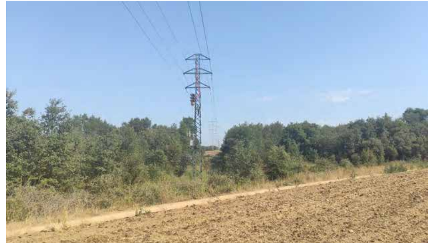
Foto7. Suport T-16b existent i línia aèria MT.
